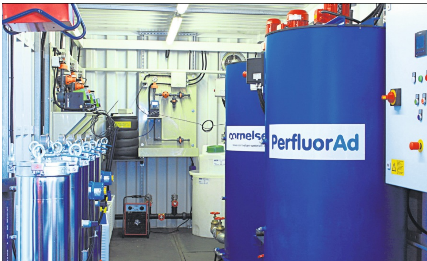
FÜR PFC-BELASTETES GRUNDWASSER sind wie hier beispielsweise bei der Firma Cornelsen, die bereits erfolgreich PFC-Sanierungen vornimmt, spezielle Wasserreinigungsanlagen entwickelt worden. Foto: pr
